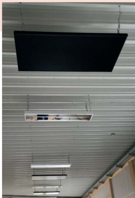
Infrarotwärmetechnik und LED Beleuchtung in einer Produktionshalle in Leutkirch. Baujahr 2016
