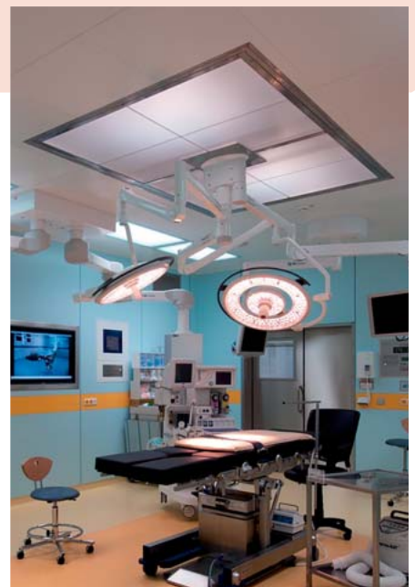
Operationsaal ausgerüstet mit modernster Reinraum LED-Beleuchtung
